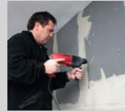
Nach Erhärtung des Klebemörtels werden die Bohrungen für die Dübel (ca. 5 Stck./m 2 ) gesetzt.
