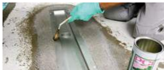
Nach dem Einbetten der Ablaufrinne im hoch wasserbeanspruchten Bereich mit Epoxidharz-Mörtel wird der Klebeflansch mit der Epoxidharz-Grundierung PCI Epoxigrund 390 oder PCI Elastoprimer 220 grundiert und im frischen Zustand mit feuergetrocknetem Quarzsand abgestreut.
