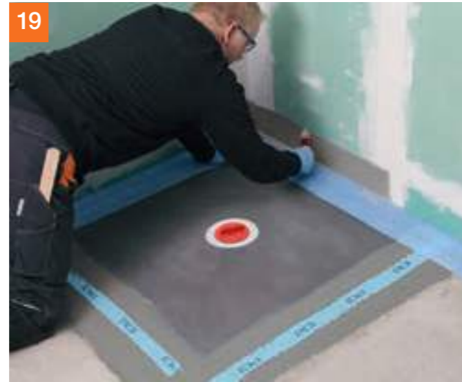
19 Nächster Schritt: Abdichten der Wand-/Bodenanschlüsse. Tipp: Zur Vermeidung von Schallbrücken vor der Applikation von PCI Seccoral® 1K / 2K Rapid an der Wand den Wand-/Bodenanschluss abdecken.
