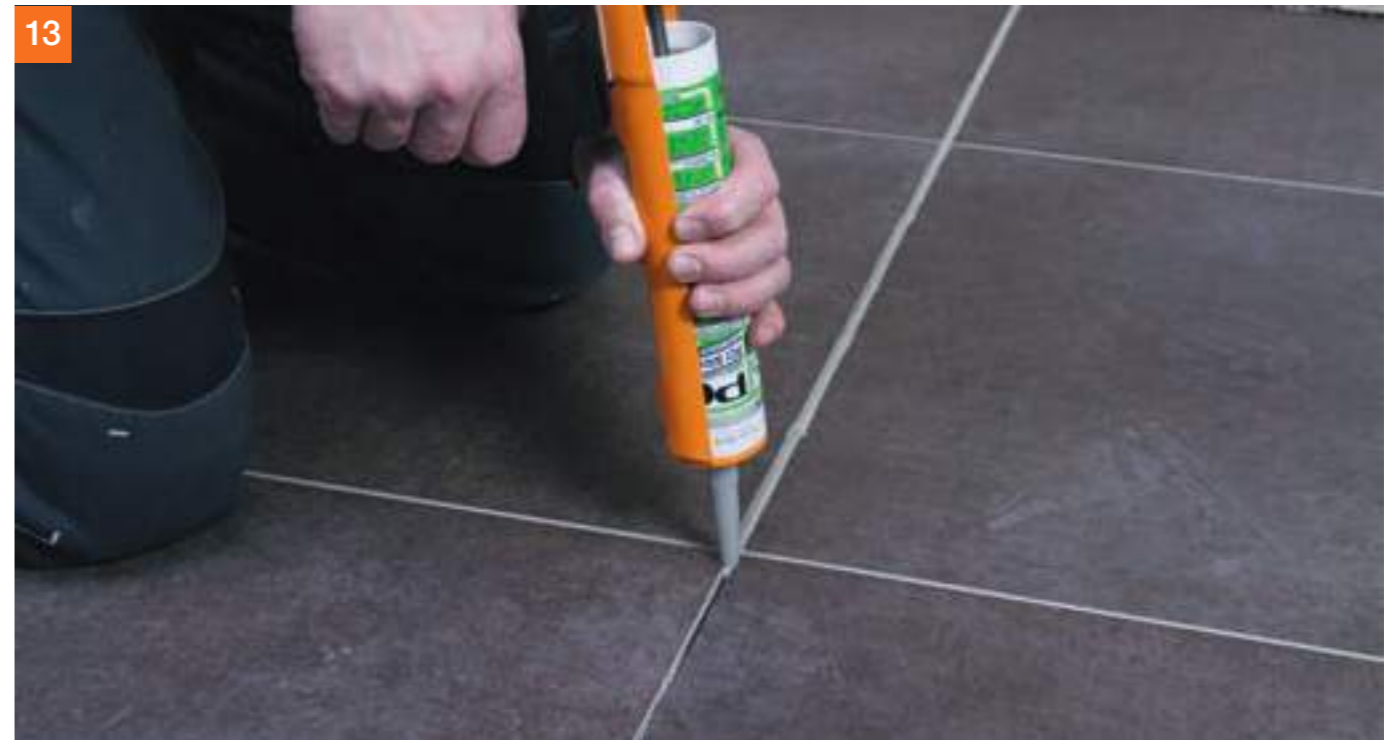
Nach dem Verfugen der Bodenfläche mit PCI Nanofug® Premium wird die an die Trennfuge angrenzende Belagsfuge mit PCI Silcofug® E versiegelt. Diese muss nicht breiter als die übrigen Belagsfugen ausgeführt werden und fügt sich so harmonisch in das Fugenbild ein.
